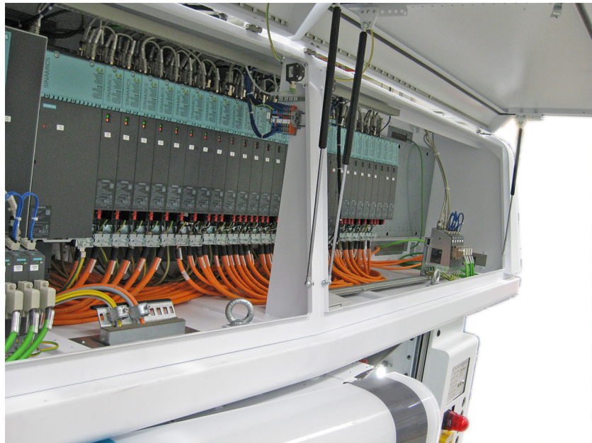
Beispiel: Schaltschranktüren an einer Mehrspindel- Drehmaschine
